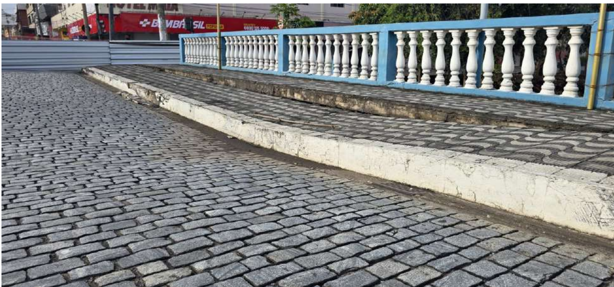
Imagem 8 Vista do abatimento do tabuleiro e balanço transversal (jusante).
