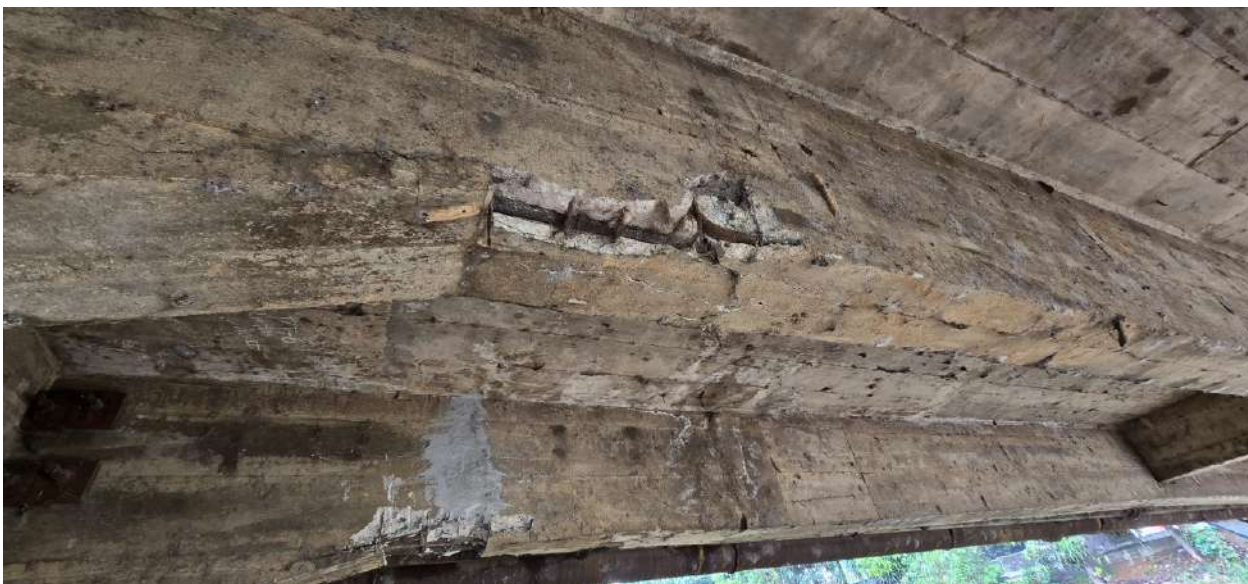
Imagem 65 Detalhe da viga longitudinal VL 2 e VL 1 fissurada, com deslocamento severo e corrosão de armaduras, próximo ao pilar P1 vão entre pilar P2 e pilar P1. Face jusante.
