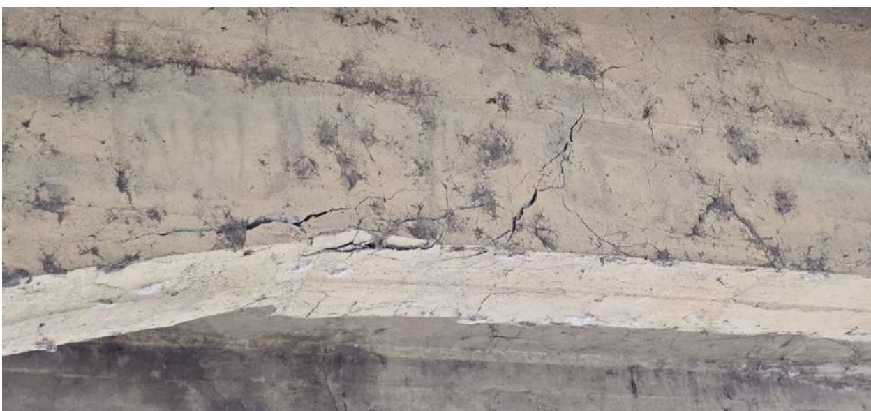
Imagem 56 Detalhe da viga longitudinal VL 3 rompida em situação de colapso, próximo ao pilar P2 vão entre pilar P2 e pilar P1. Face montante.
