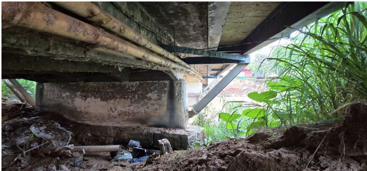
Imagem 68 Vista do pilar P1 face para o encontro 1 com manchas e proliferação biológicas. Detalhe para pórtico da passarela de pedestre com apoio lateral no P1 em ambos os lados.
