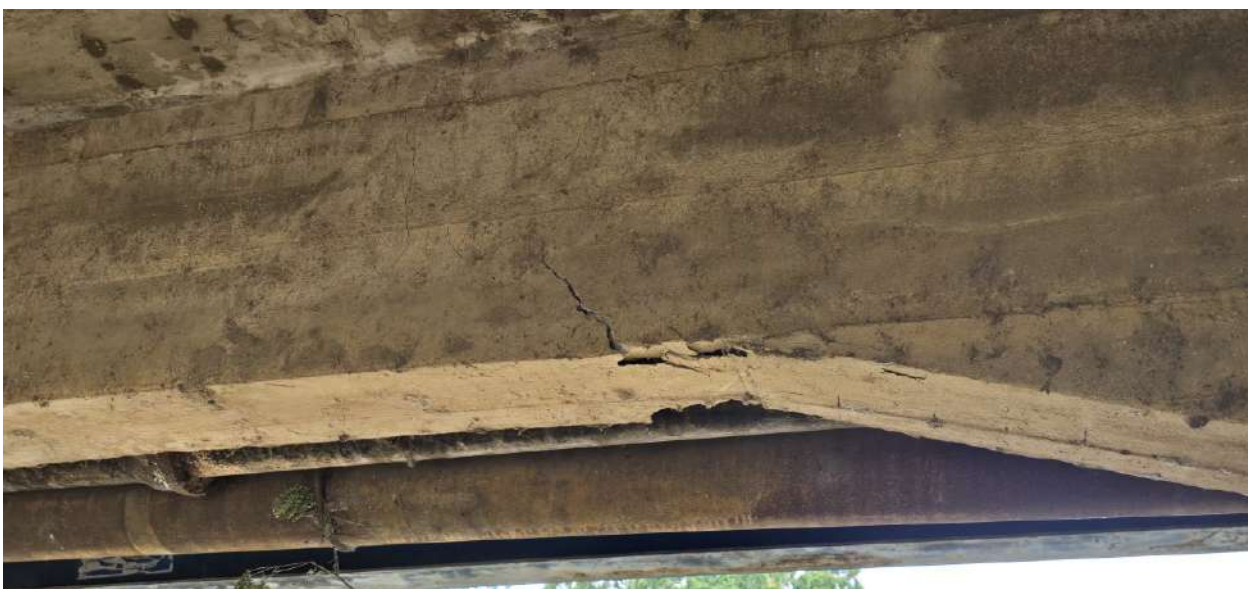
Imagem 54 Detalhe da viga longitudinal VL 1 rompida em situação de colapso, próximo ao pilar P2 vão entre pilar P2 e pilar P1. Face jusante.
