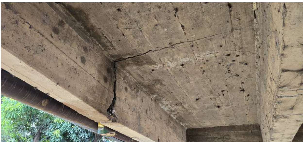
Imagem 21 Vista de quadro fissuratório severo na laje/tabuleiro por toda seção transversal entre o pilar P2 e o encontro 2.
