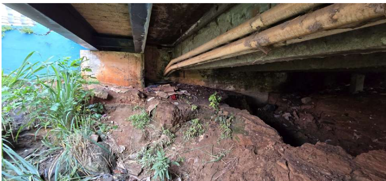
Imagem 24 Vista do encontro 1 com rede de drenagem urbana despejando diretamente no talude causando erosões severas.
