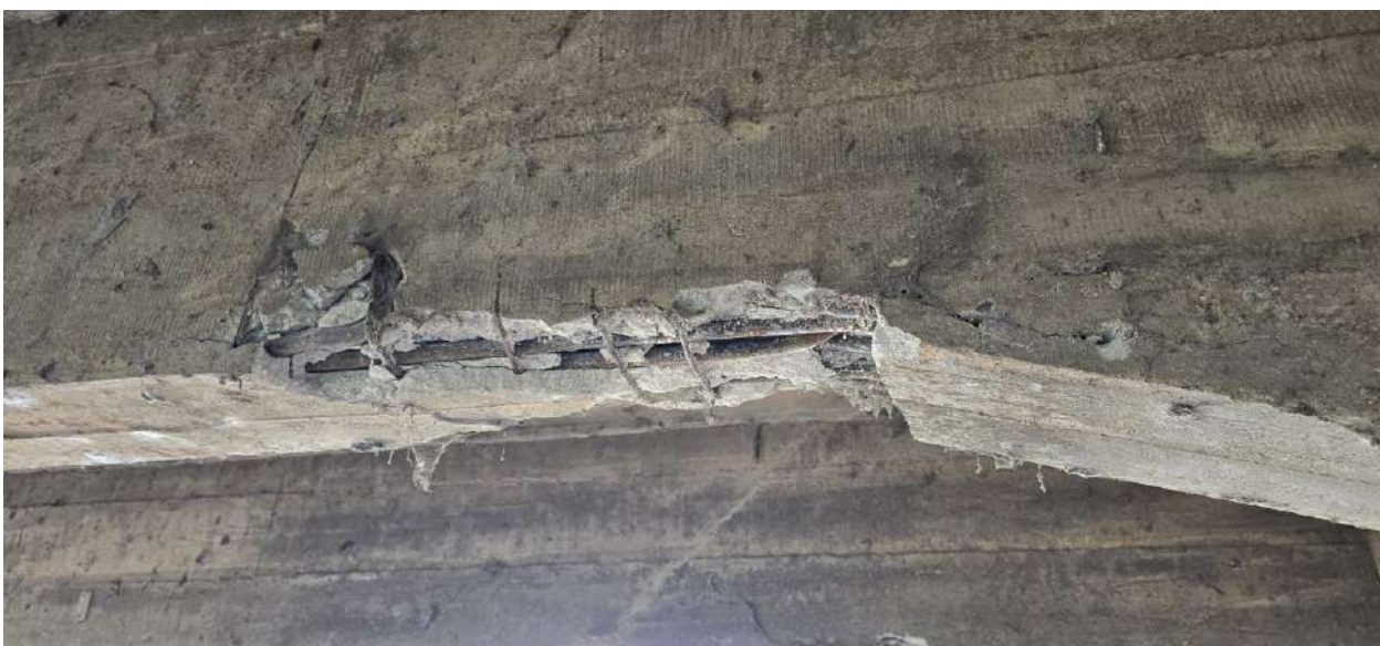
Imagem 64 Detalhe da viga longitudinal VL 2 fissurada, com deslocamento severo e corrosão de armaduras, próximo ao pilar P1 vão entre pilar P2 e pilar P1. Face montante. Após deslocamento manual.
