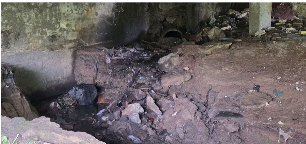
Imagem 26 Vista do encontro 1 com rede de drenagem urbana despejando diretamente no talude causando erosões severas.
