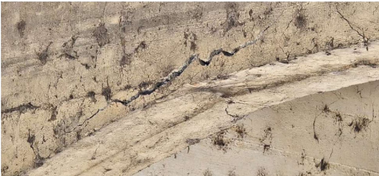
Imagem 55 Detalhe da viga longitudinal VL 2 rompida em situação de colapso, próximo ao pilar P2 vão entre pilar P2 e pilar P1. Face montante.
