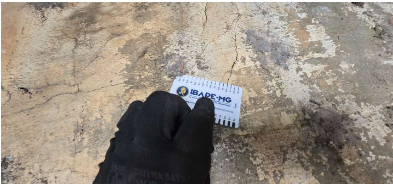
Imagem 30 Vista do encontro 2 com fissuras de 0,65 mm.
