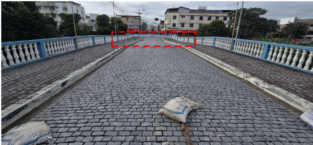
Imagem 6 Vista de abatimento do tabuleiro no vão entre o pilar P2 e encontro 2, junto à Av. Rio Branco.
