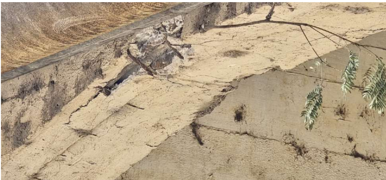
Imagem 53 Detalhe da viga longitudinal VL 1 rompida em situação de colapso, próximo ao pilar P2 vão entre pilar P2 e pilar P1. Face montante.
