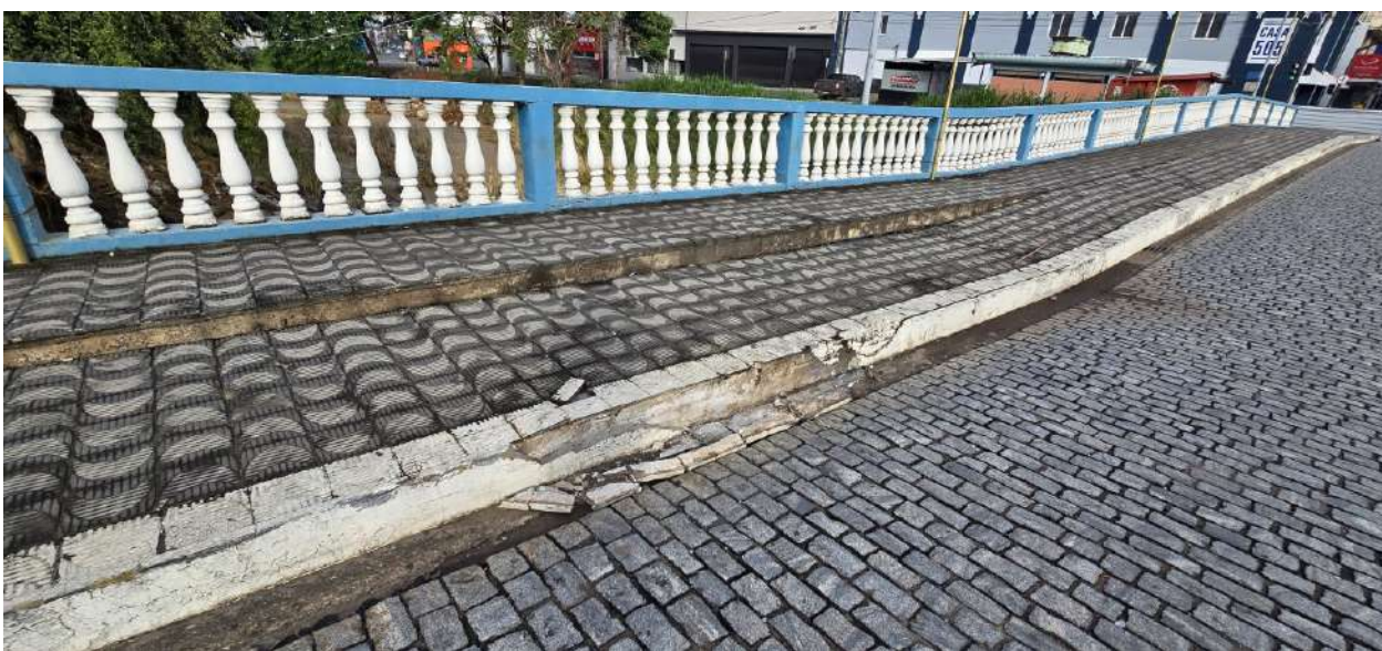
Imagem 9 Vista do abatimento do tabuleiro e balanço transversal (jusante).
