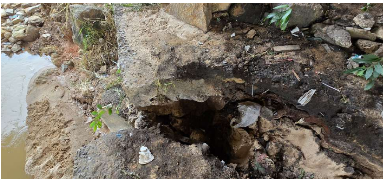
Imagem 36 Vista da contenção junto ao encontro 2 colapsada e degradação avançada.
