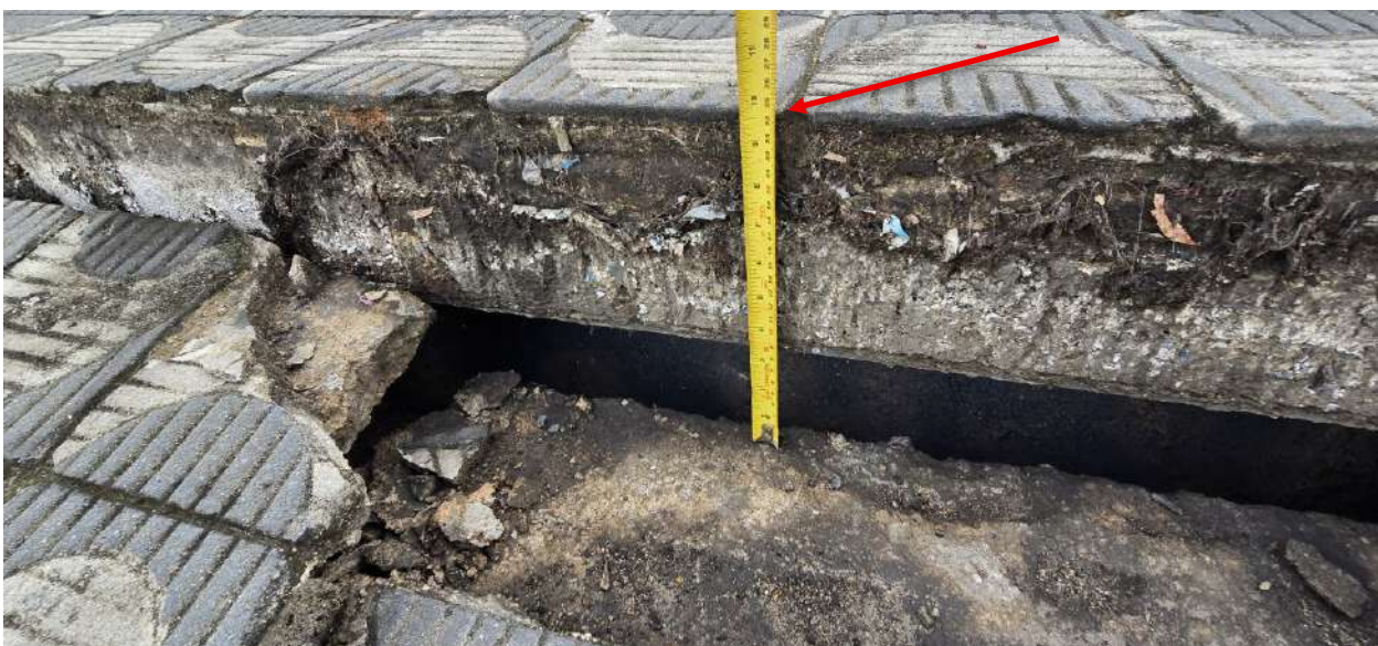
Imagem 11 Vista do abatimento do tabuleiro e balanço transversal (montante) com 0,24 m. de desnível.
