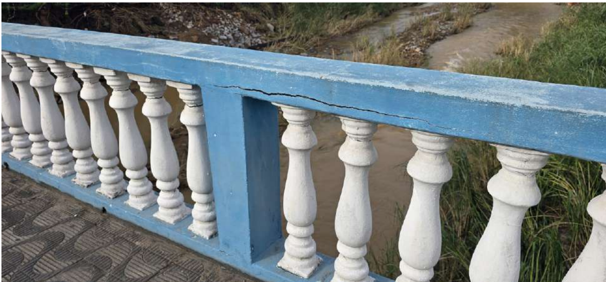
Imagem 16 Vista de fissura na viga do guarda-corpo (jusante).
