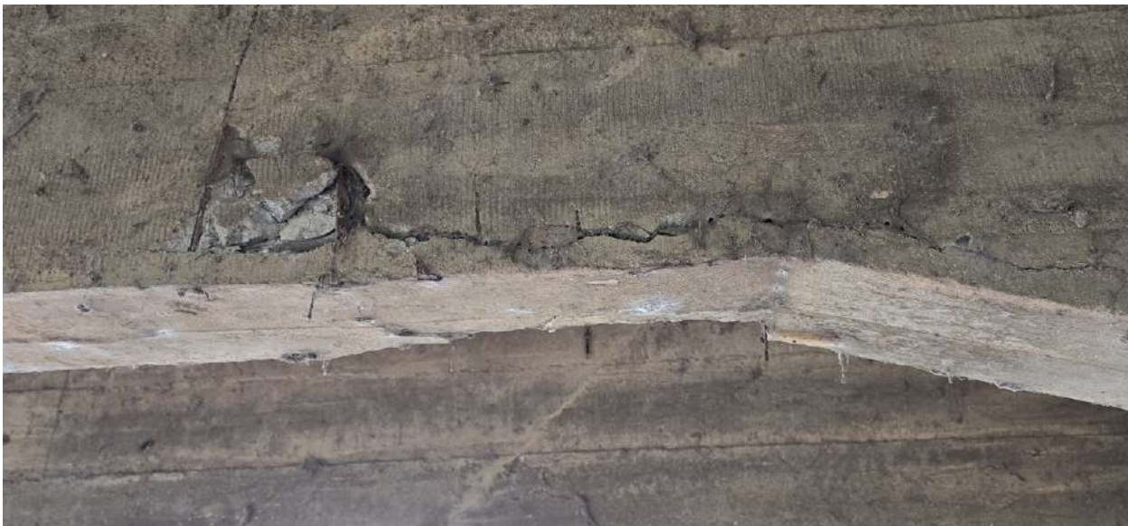
Imagem 63 Detalhe da viga longitudinal VL 2 fissurada, com deslocamento severo e corrosão de armaduras, próximo ao pilar P1 vão entre pilar P2 e pilar P1. Face montante.
