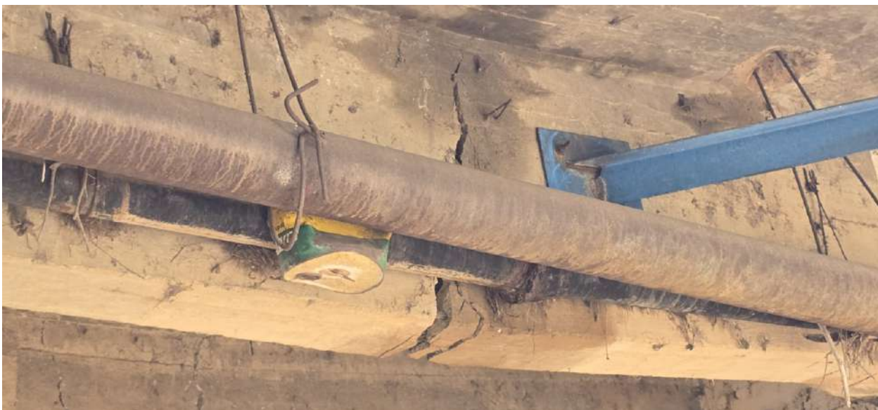
Imagem 47 Detalhe da viga longitudinal VL1 rompida em situação de colapso, próximo ao P2 vão entre P2 e encontro 2. Face montante.
