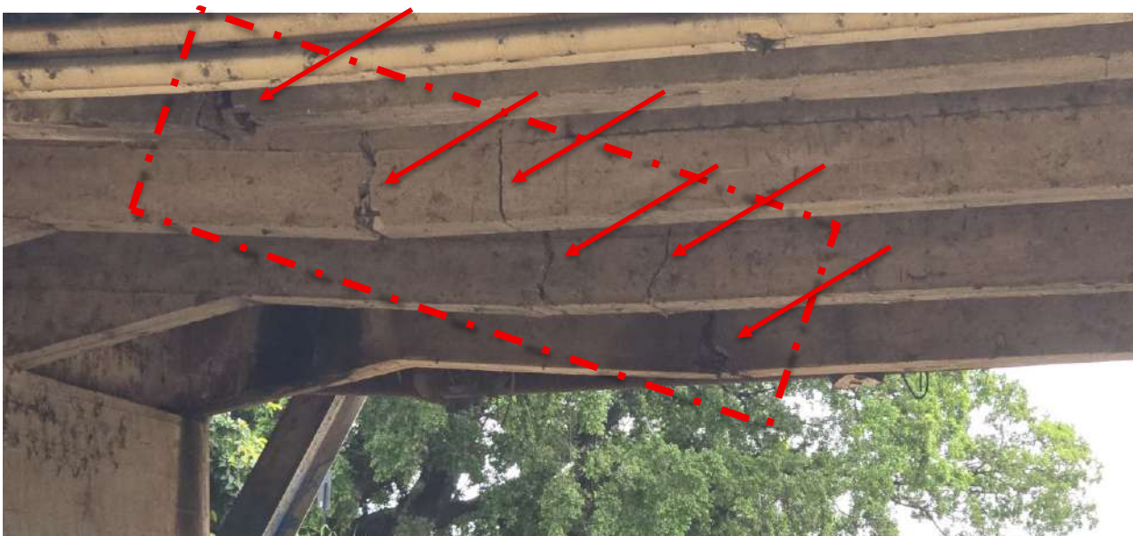
Imagem 39 Vista de região com vigas longarina rompidas em situação de colapso, próximo ao P2 vão entre P2 e encontro 2. Face jusante.
