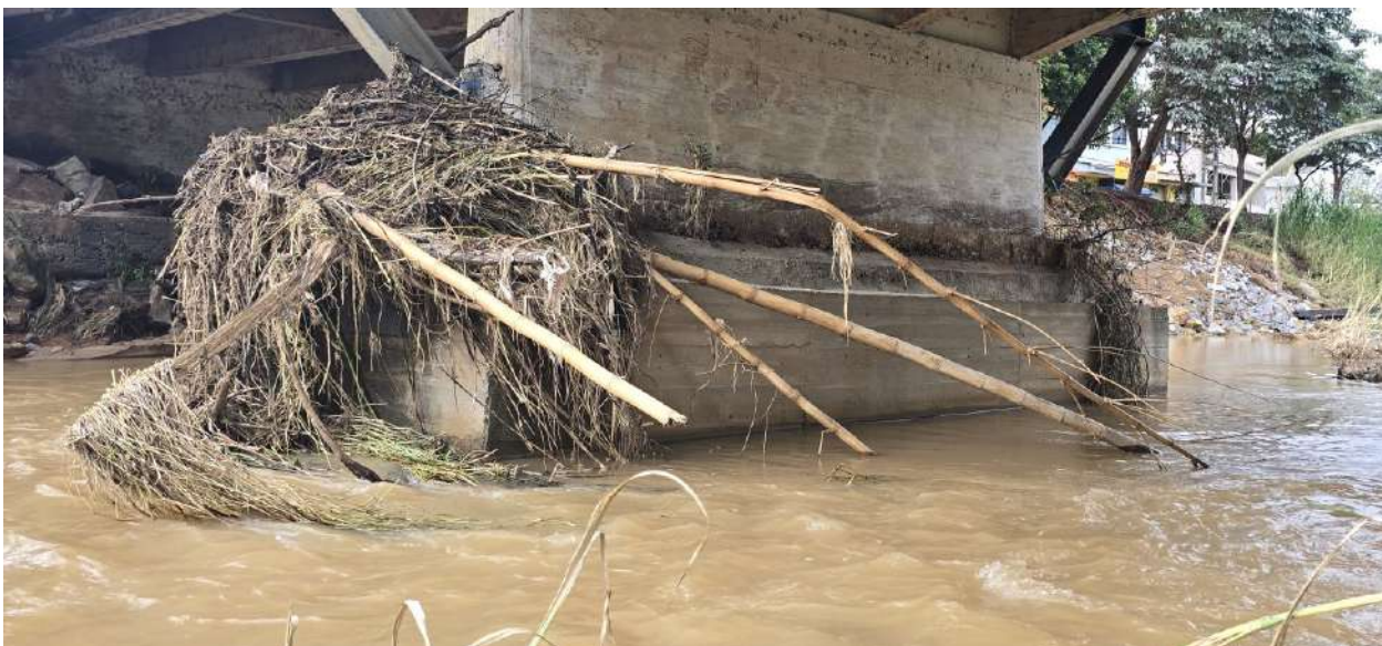
Imagem 78 Vista do pilar P2 face para pilar P1.
