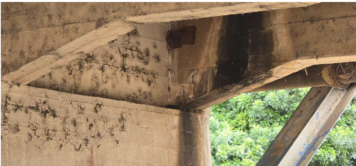
Imagem 51 Vista da longarina VL1 sob grelha metálica de drenagem do tabuleiro com deslocamentos, corrosão de armaduras generalizadas por ausência de condutos buzínos das águas de drenagem, junto ao P2 vão entre P2 e encontro 2.
