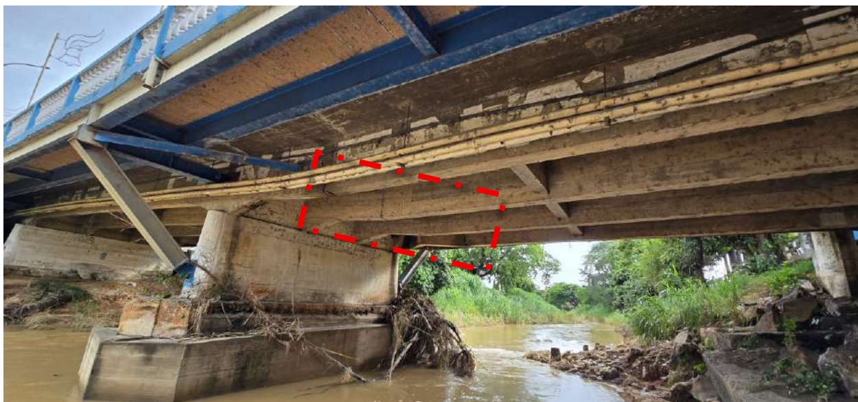
Imagem 38 Vista de região com vigas longarina rompidas em situação de colapso, próximo ao P2 vão entre P2 e encontro 2.
