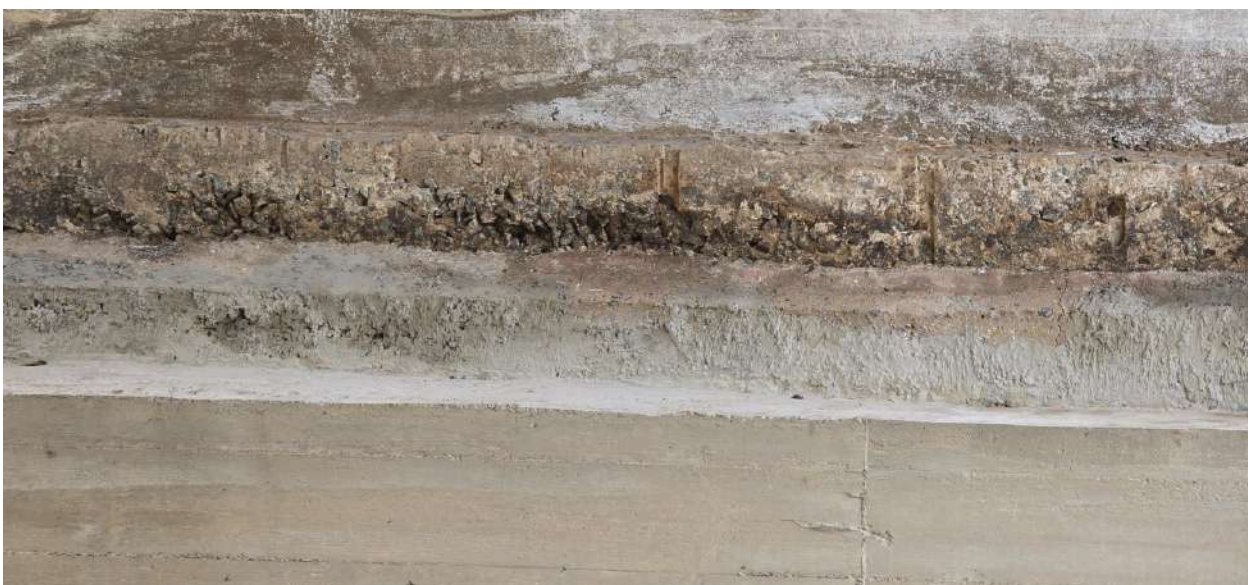
Imagem 77 Vista do pilar P2 face para pilar P1. Detalhe para concreto com segregação e erosão.
