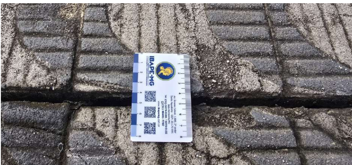
Imagem 15 Vista de rachadura transversal no passeio de pedestre com 14 mm (jusante).
