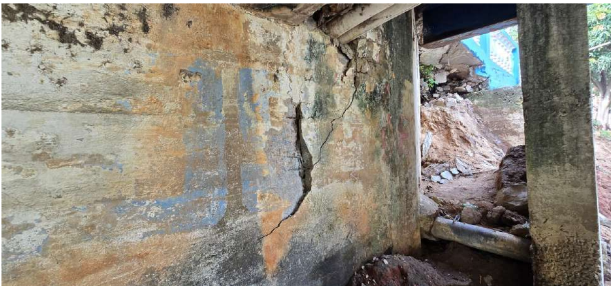
Imagem 32 Vista do encontro 2 sob viga longitudinal VL4 com quadro fissuratório generalizado e brechas.
