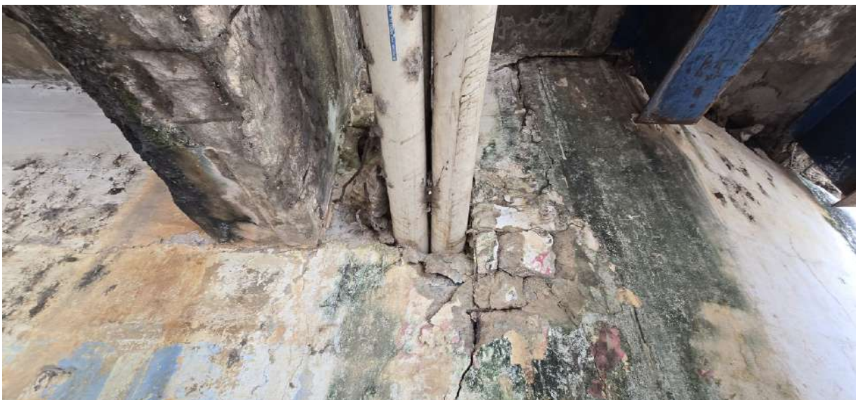
Imagem 33 Vista do encontro 2 junto a viga longitudinal VL4 com quadro fissuratório generalizado e brechas.
