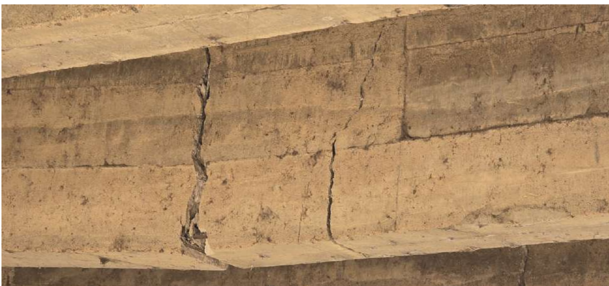
Imagem 42 Detalhe da viga longitudinal VL3 rompida em situação de colapso, próximo ao P2 vão entre P2 e encontro 2. Face jusante.
