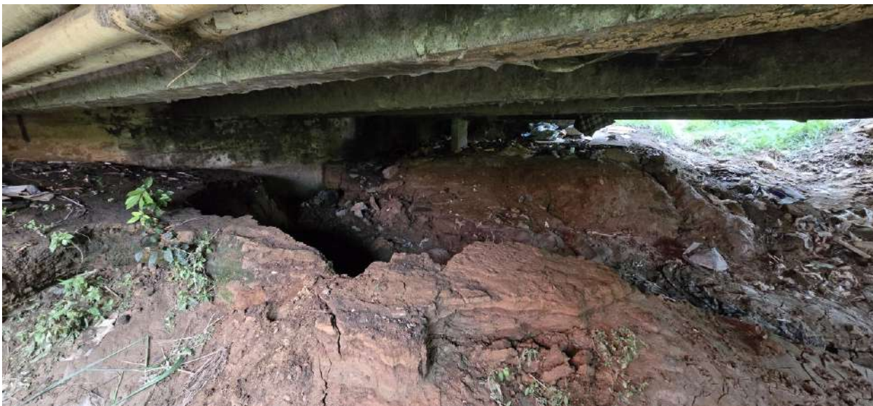
Imagem 25 Vista do encontro 1 com rede de drenagem urbana despejando diretamente no talude causando erosões severas.
