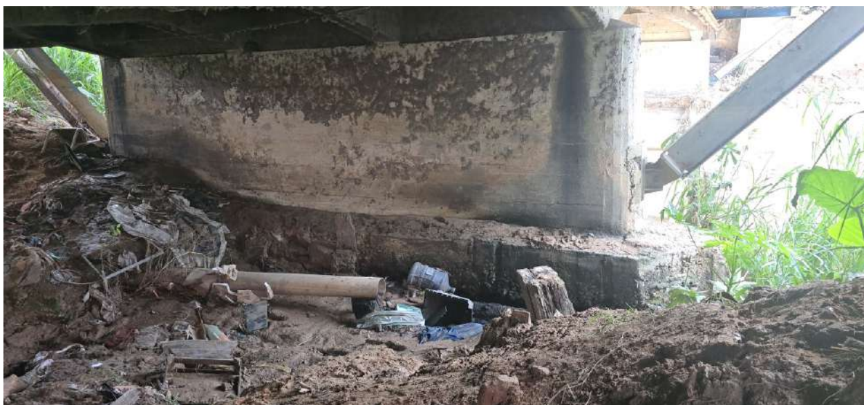
Imagem 69 Detalhe do pilar P1 face para o encontro 1 com manchas e proliferação biológicas. Bloco de coroamento de estacas com degradação severa no concreto, armaduras expostas, deformações, desaprumos, disgregações do concreto. Desgaste do sistema de pintura, assoreamento e carreamento de solo por lançamento indevido de águas pluviais por desconexão de tubulação. Acúmulo de lixo e materiais diversos.
