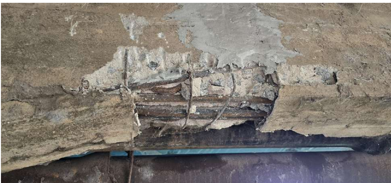
Imagem 66 Detalhe da viga longitudinal VL 1 fissurada, com deslocamento severo e corrosão de armaduras, próximo ao pilar P1 vão entre pilar P2 e pilar P1. Face jusante.
