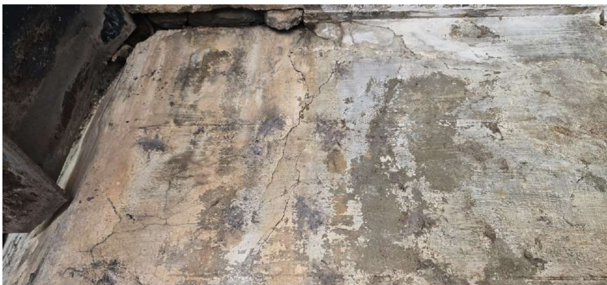
Imagem 28 Vista do encontro 2 com fissuras generalizadas.
