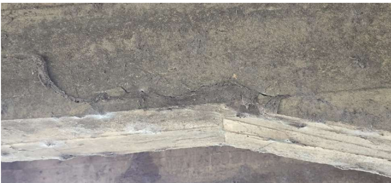
Imagem 60 Detalhe da viga longarina VL 3 fissurada, próximo ao pilar P1 vão entre pilar P2 e pilar P1. Face montante.
