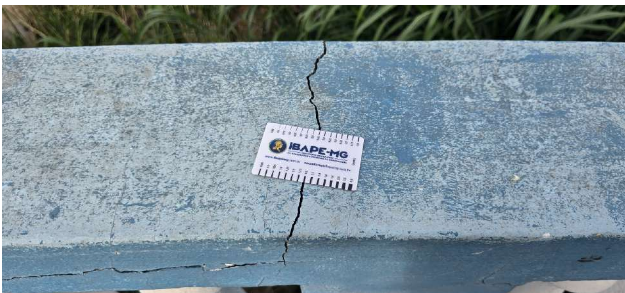
Imagem 17 Vista de fissura no guarda-corpo com 1,2 mm (jusante).
