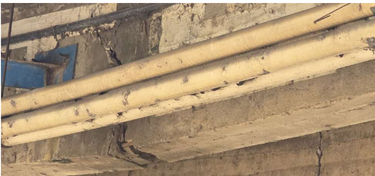
Imagem 40 Detalhe da viga longarina VL4 rompida em situação de colapso, próximo ao P2 vão entre P2 e encontro 2. Face jusante.
