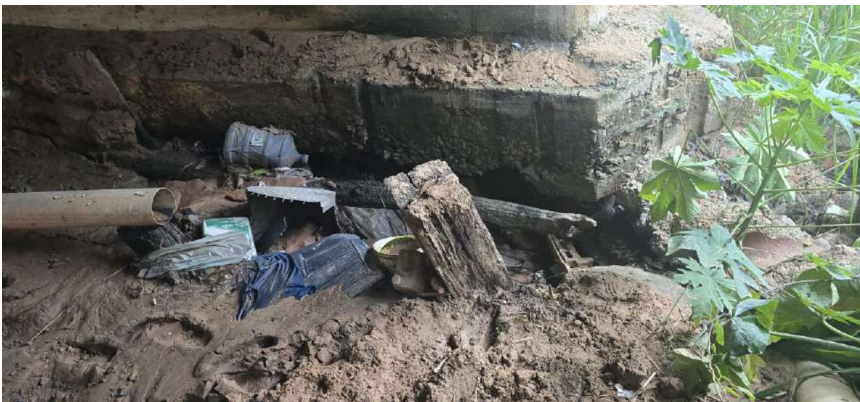
Imagem 70 Detalhe do pilar P1 face para o encontro 1. Bloco de coroamento de estacas com degradação severa no concreto, armaduras expostas, assoreamento e carregamento de solo por lançamento indevido de águas pluviais por desconexão de tubulação.
