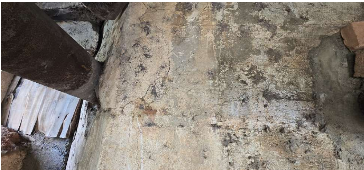
Imagem 29 Vista do encontro 2 com fissuras generalizadas.
