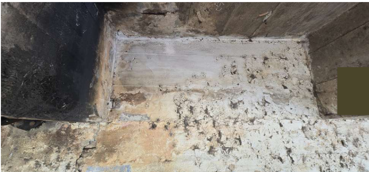
Imagem 31 Vista do encontro 2 entre viga longitudinal VL3 e VL4 com quadro fissuratório generalizado.
