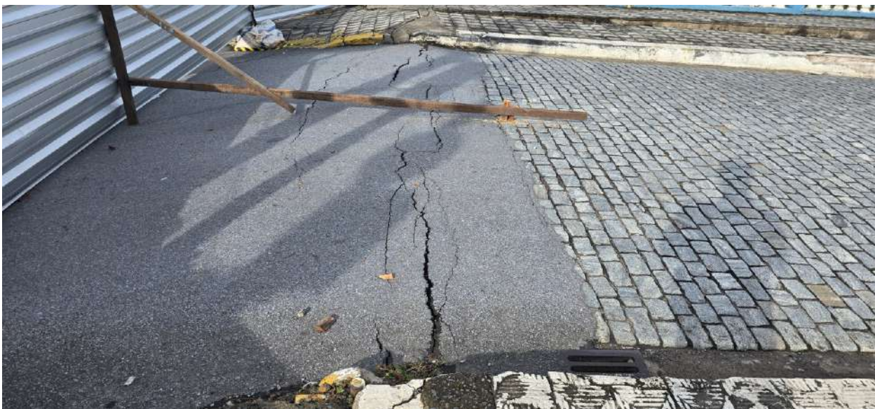
Imagem 20 Vista de brechas no revestimento asfáltico na interface tabuleiro encontro 2.
