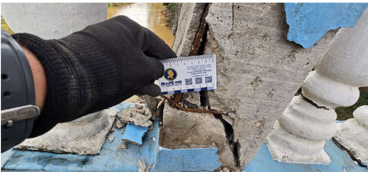
Imagem 13 Vista do guarda-corpo com pilaretes, balaústres e vigas rompidas (montante) fissuras com 10 mm.
