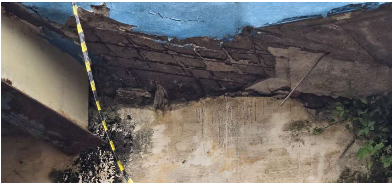
Imagem 35 Vista da laje da calçada junto ao encontro 2 com corrosão de armaduras generalizada, perda de seção dos vergalhões, erosão, quadro fissuratório generalizado e proliferação biológica.
