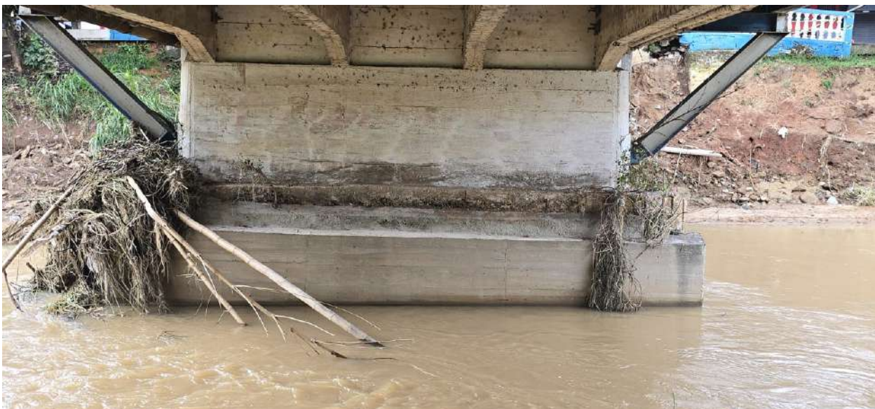
Imagem 76 Vista do pilar P2 face para pilar P1. Detalhe para detritos acumulados na base do apoio.
