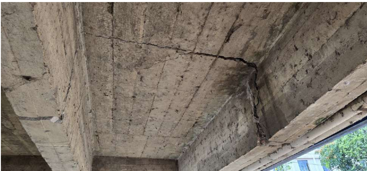
Imagem 22 Vista de quadro fissuratório severo na laje/tabuleiro por toda seção transversal entre o pilar P2 e o encontro 2.
