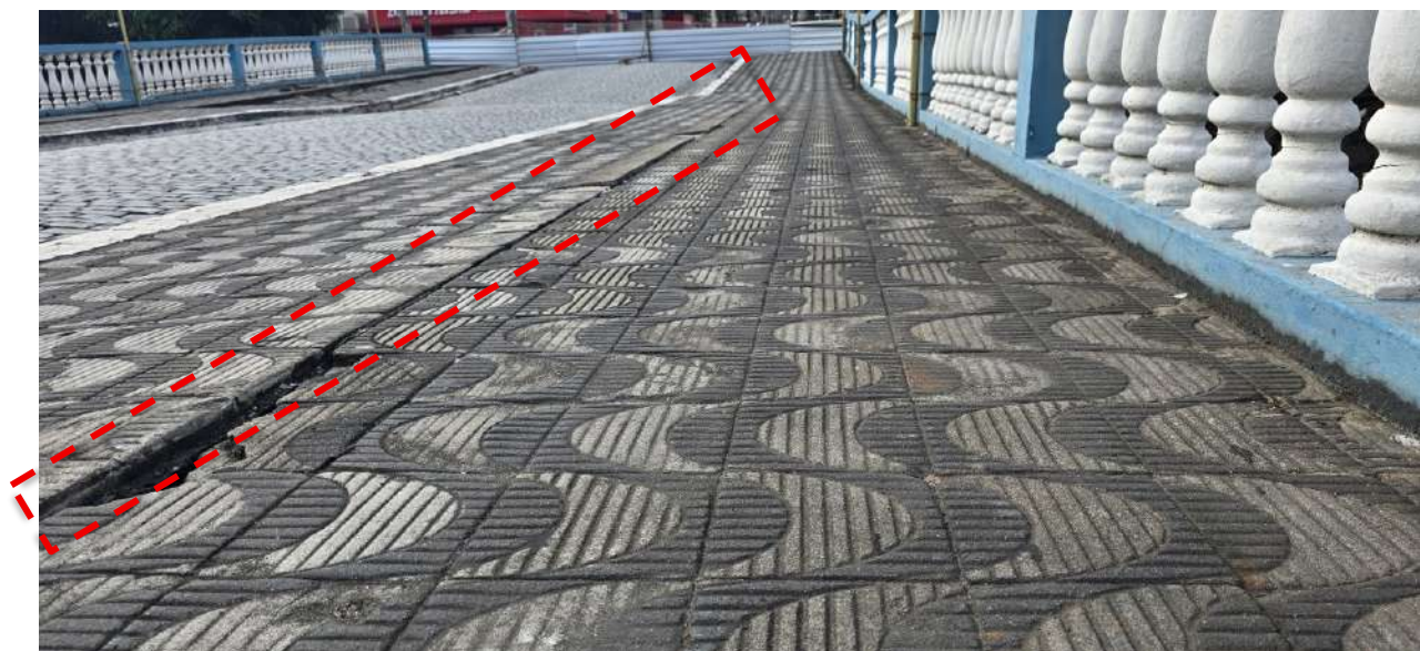
Imagem 7 Vista de fissura entre balanço transversal (jusante) e passeio de pedestre.
