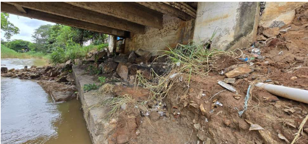
Imagem 37 Vista da contenção junto ao encontro 2 colapsada e degradação avançada. Detalhe para talude (jusante) com erosão, detritos e entulhos.
