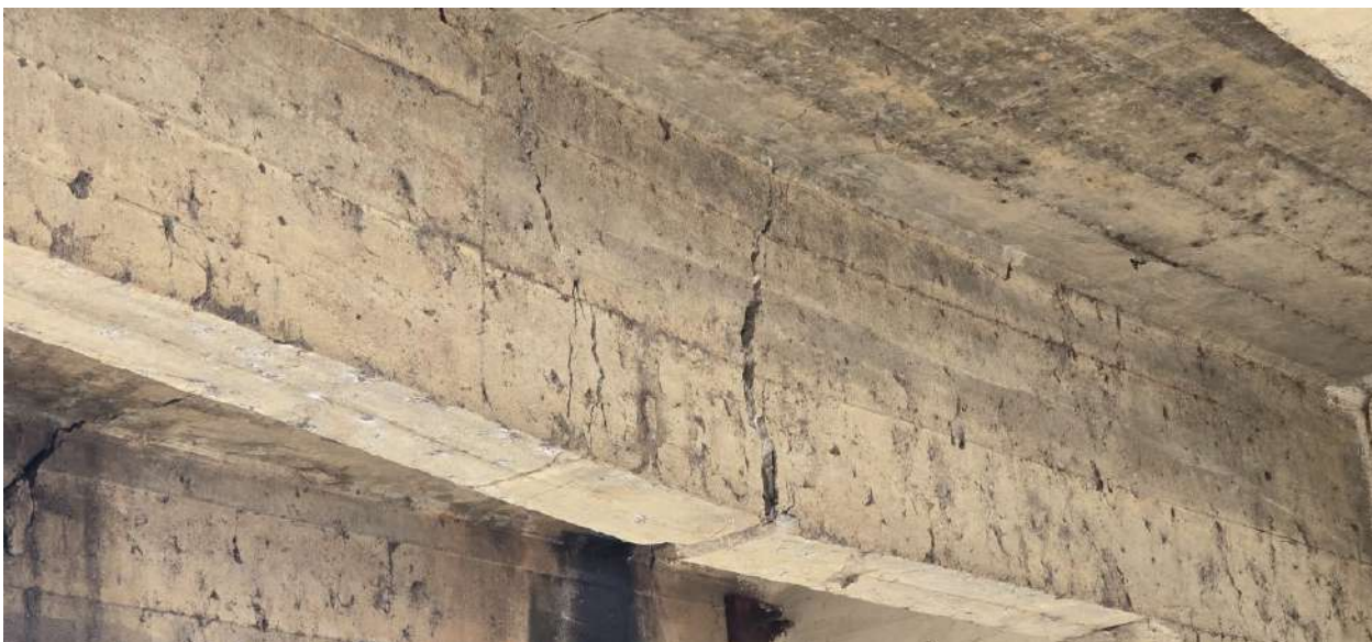
Imagem 43 Detalhe da viga longitudinal VL3 rompida em situação de colapso, próximo ao P2 vão entre P2 e encontro 2. Face montante.
