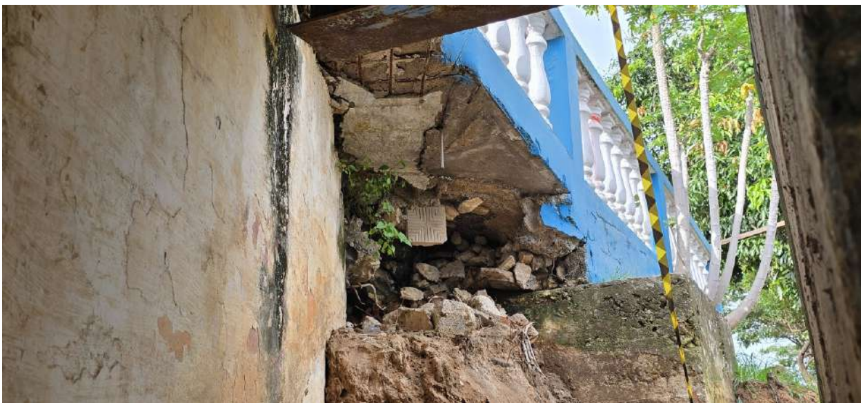
Imagem 34 Vista da laje da calçada sobre ala junto ao encontro 2 com corrosão de armaduras generalizada, perda de seção dos vergalhões, erosão, quadro fissuratório generalizado e proliferação biológica.
