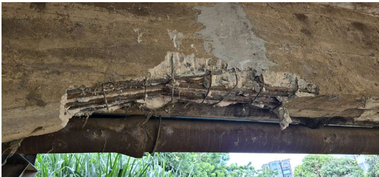
Imagem 67 Detalhe da viga longitudinal VL 1 fissurada, com deslocamento severo e corrosão de armaduras, próximo ao pilar P1 vão entre pilar P2 e pilar P1. Face jusante. Após deslocamento manual.
