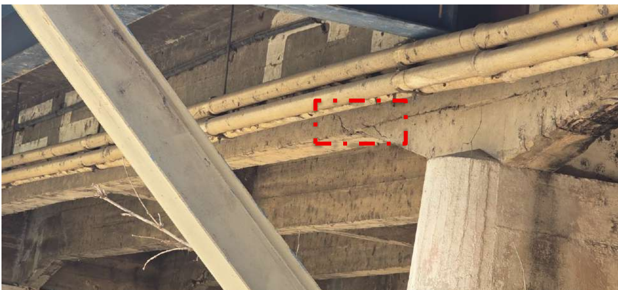
Imagem 58 Detalhe da viga longarina VL 4 rompida em situação de colapso, próximo ao pilar P2 vão entre pilar P2 e pilar P1. Face jusante.
