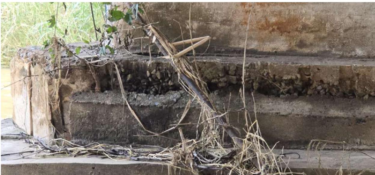
Imagem 82 Vista do pilar P2 face para encontro 2. Detalhe para concreto com segregação e erosão.
