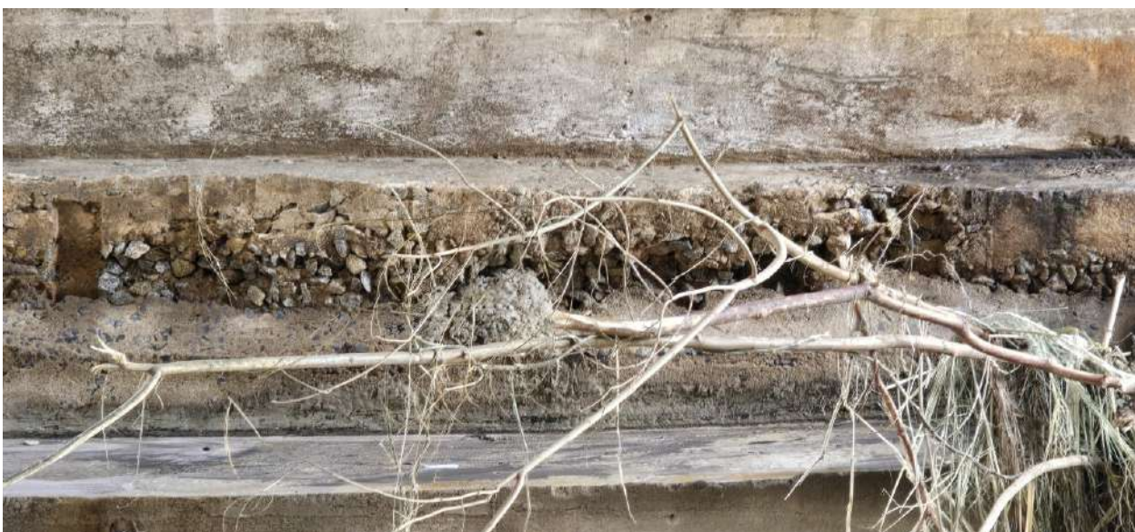
Imagem 83 Vista do pilar P2 face para encontro 2. Detalhe para concreto com segregação e erosão.
