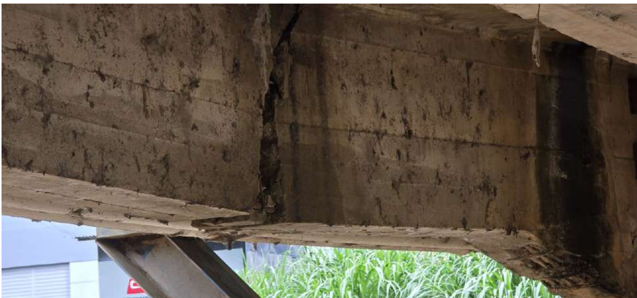
Imagem 41 Detalhe da viga longitudinal VL4 rompida em situação de colapso, próximo ao P2 vão entre P2 e encontro 2. Face montante.
