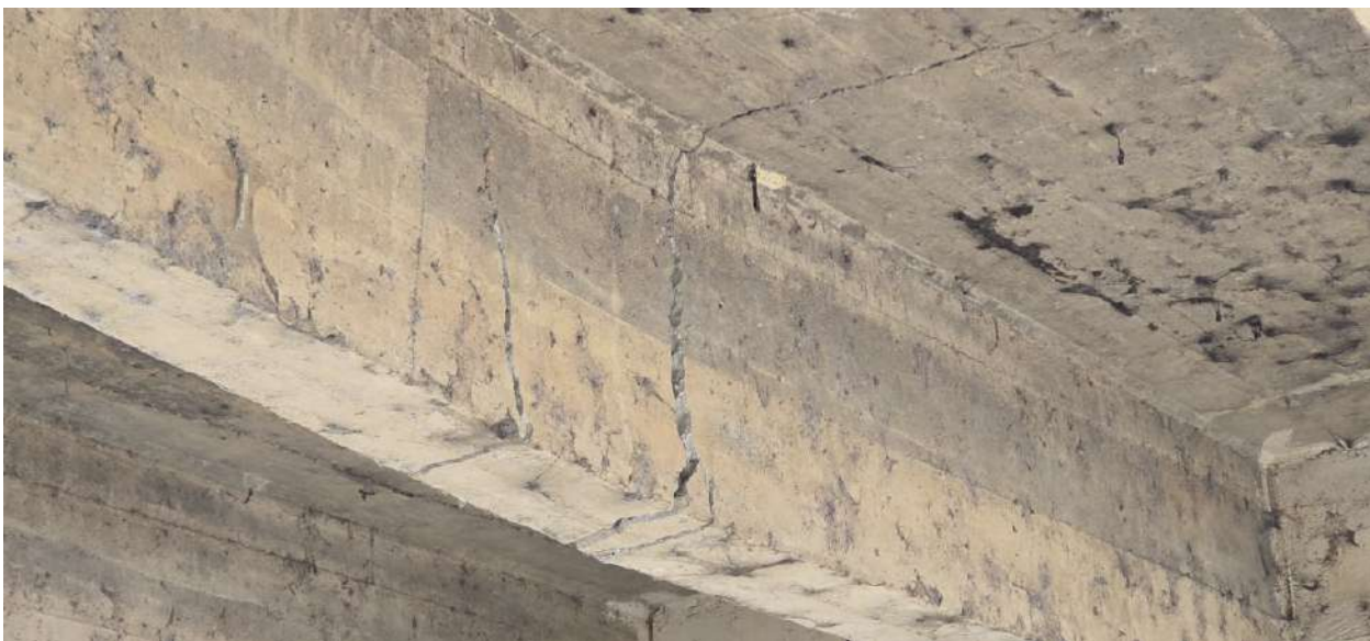
Imagem 45 Detalhe da viga longitudinal VL2 rompida em situação de colapso, próximo ao P2 vão entre P2 e encontro 2. Face montante.
