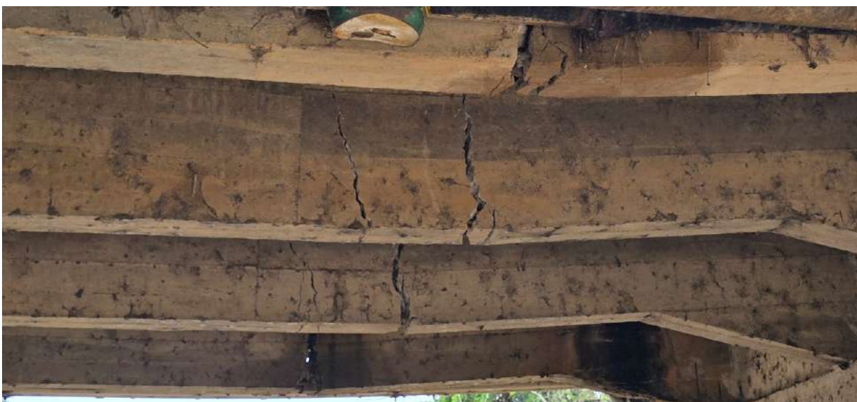
Imagem 48 Vista de região com vigas longitudinal rompidas em situação de colapso, próximo ao P2 vão entre P2 e encontro 2. Face montante.
