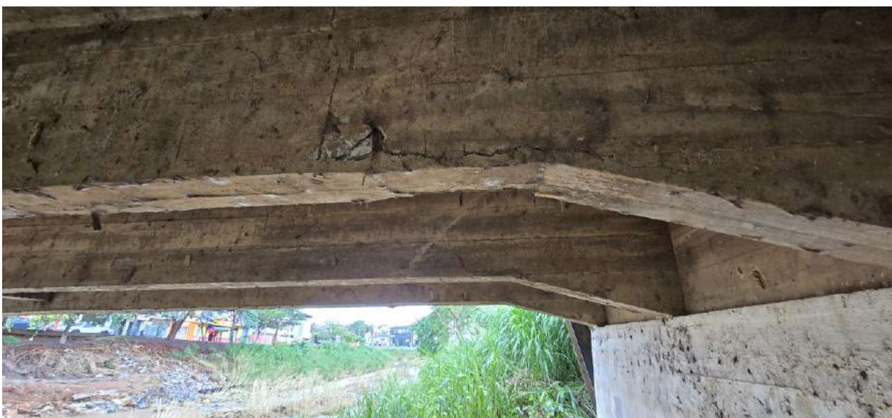
Imagem 62 Detalhe da viga longitudinal VL 2 fissurada, com deslocamento severo e corrosão de armaduras, próximo ao pilar P1 vão entre pilar P2 e pilar P1. Face montante.
