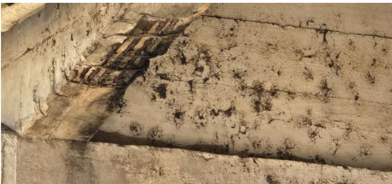
Imagem 50 Vista da longarina VL4 sob grelha metálica de drenagem do tabuleiro com deslocamentos, corrosão de armaduras generalizadas, manchamentos, por ausência de condutos buzinos das águas de drenagem, junto ao P2 vão entre P2 e encontro 2.
