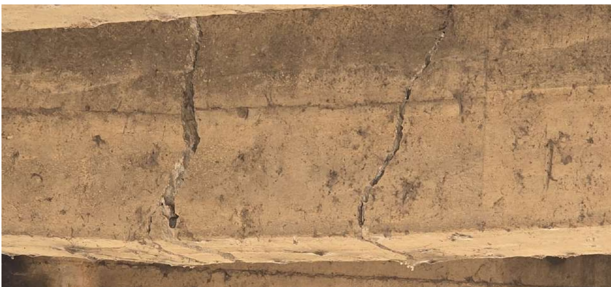
Imagem 44 Detalhe da viga longitudinal VL2 rompida em situação de colapso, próximo ao P2 vão entre P2 e encontro 2. Face jusante.
