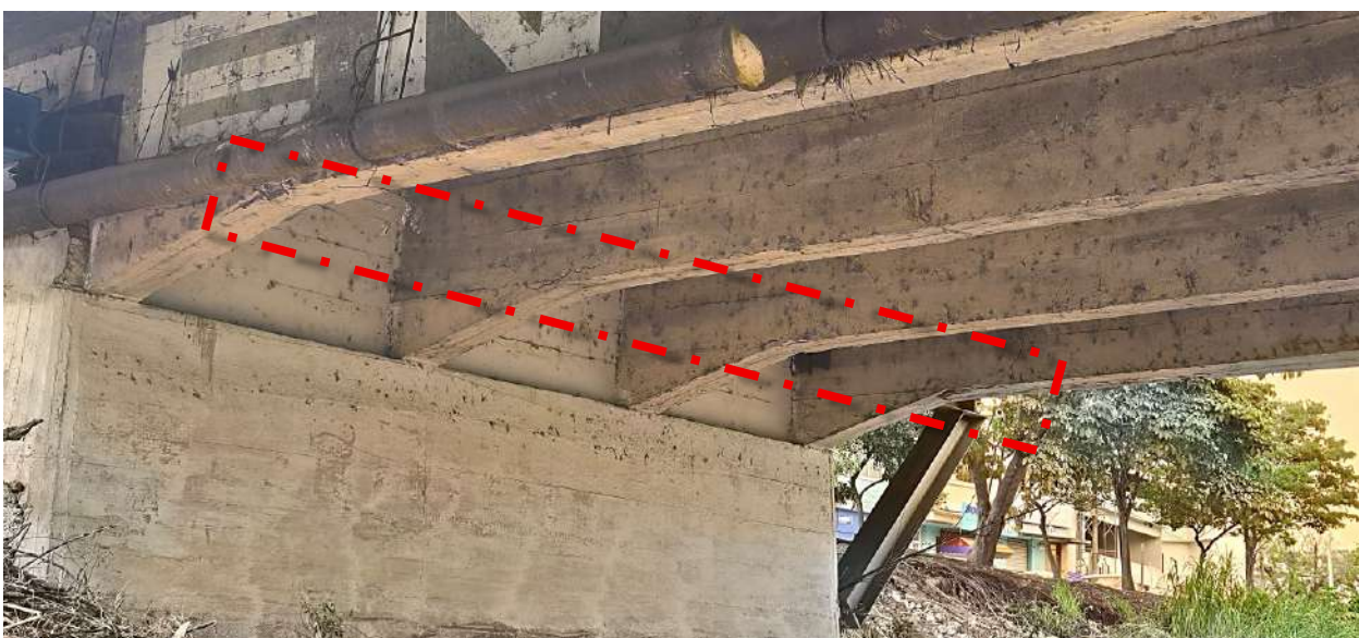
Imagem 52 Vista de região com vigas longarinas rompidas em situação de colapso, próximo ao pilar P2 vão entre pilar P2 e pilar P1. Face montante.
