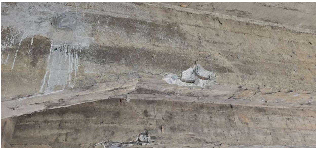
Imagem 61 Detalhe da viga longitudinal VL 3 fissurada, próximo ao pilar P1 vão entre pilar P2 e pilar P1. Face jusante.
