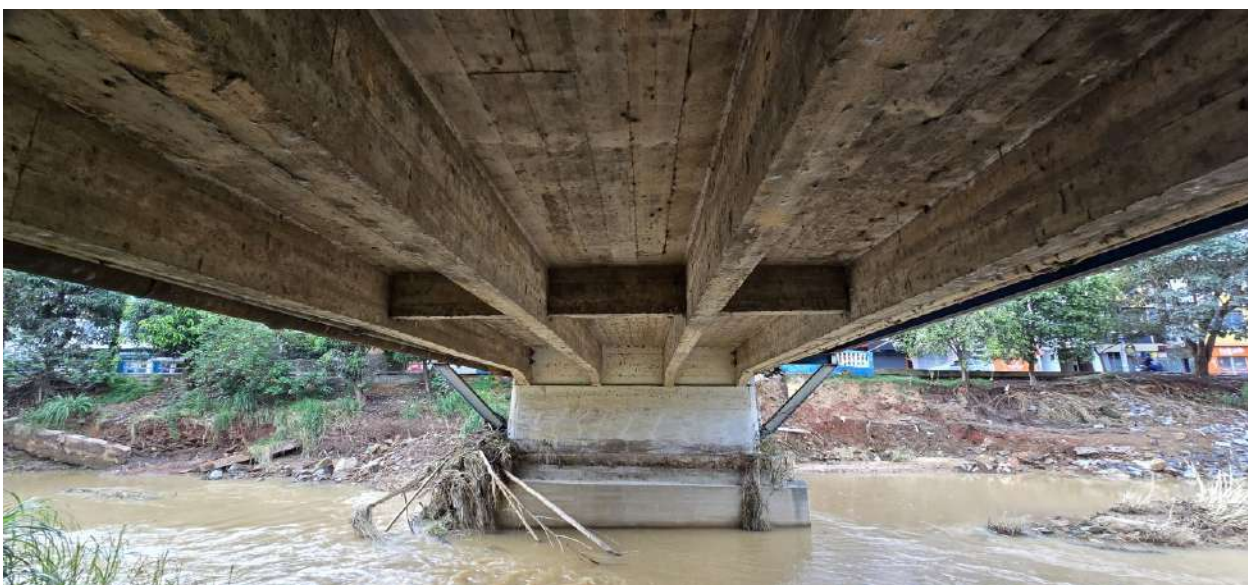
Imagem 75 Vista do pilar P2 face para pilar P1.
