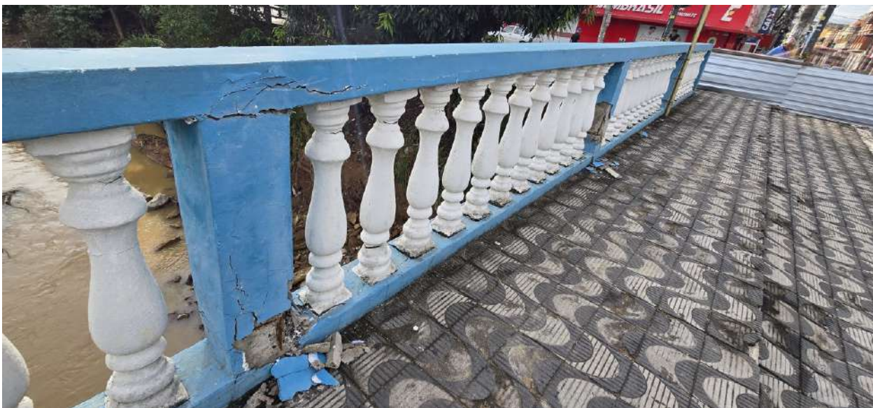
Imagem 12 Vista do guarda-corpo com pilaretes, balaústres e vigas rompidas (montante).
