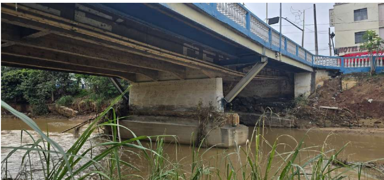
Imagem 73 Vista do pilar P2 face para pilar P1.
