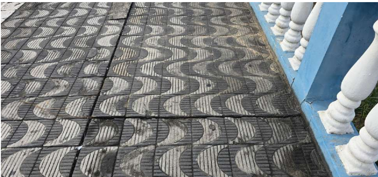
Imagem 14 Vista de rachadura no passeio de pedestre e entre balanço transversal e passeio (jusante).
