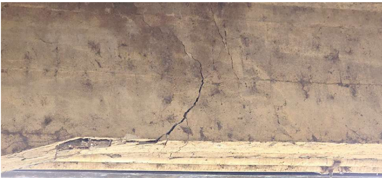
Imagem 57 Detalhe da viga longarina VL 4 rompida em situação de colapso, próximo ao pilar P2 vão entre pilar P2 e pilar P1. Face montante.
