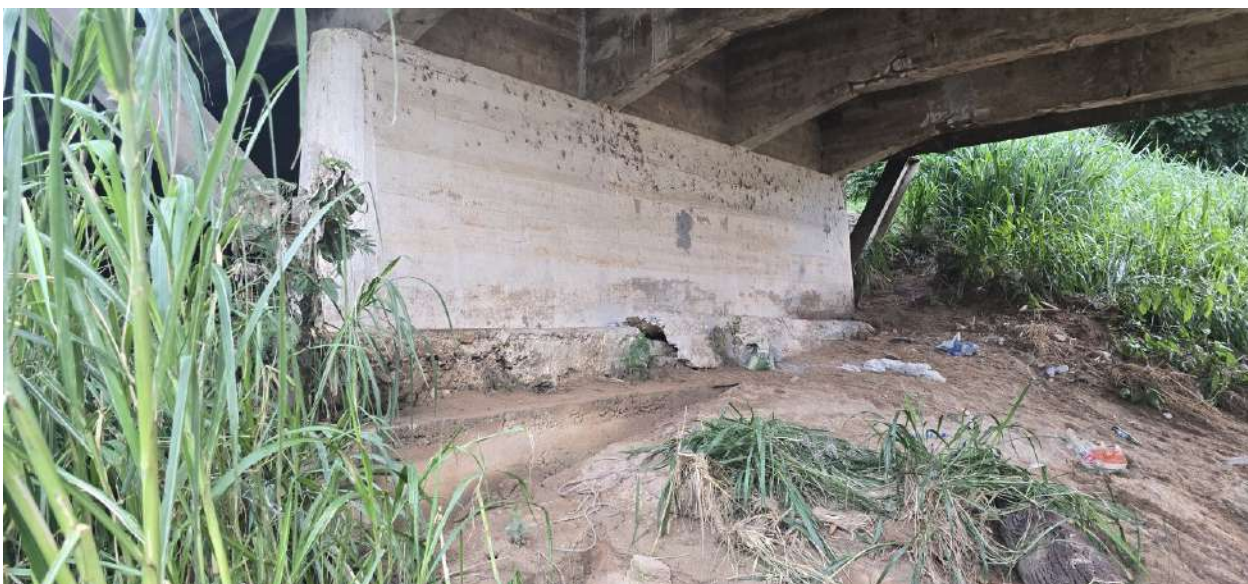
Imagem 71 Detalhe do pilar P1 face para o pilar P1. Bloco de coroamento de estacas com degradação severa no concreto, defeitos construtivos, deformações, concreto rompido, disgregação.
