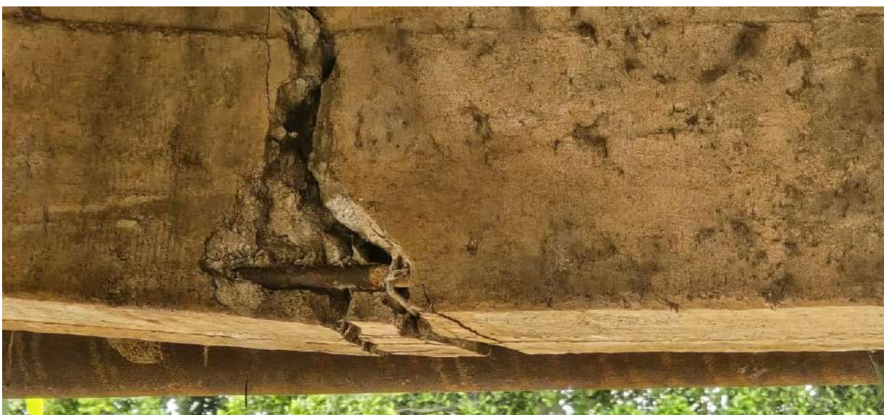
Imagem 46 Detalhe da viga longitudinal VL1 rompida em situação de colapso, próximo ao P2 vão entre P2 e encontro 2. Face jusante.
