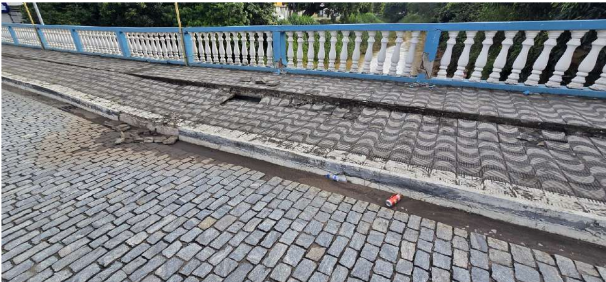
Imagem 10 Vista do abatimento do tabuleiro e balanço transversal (montante).
