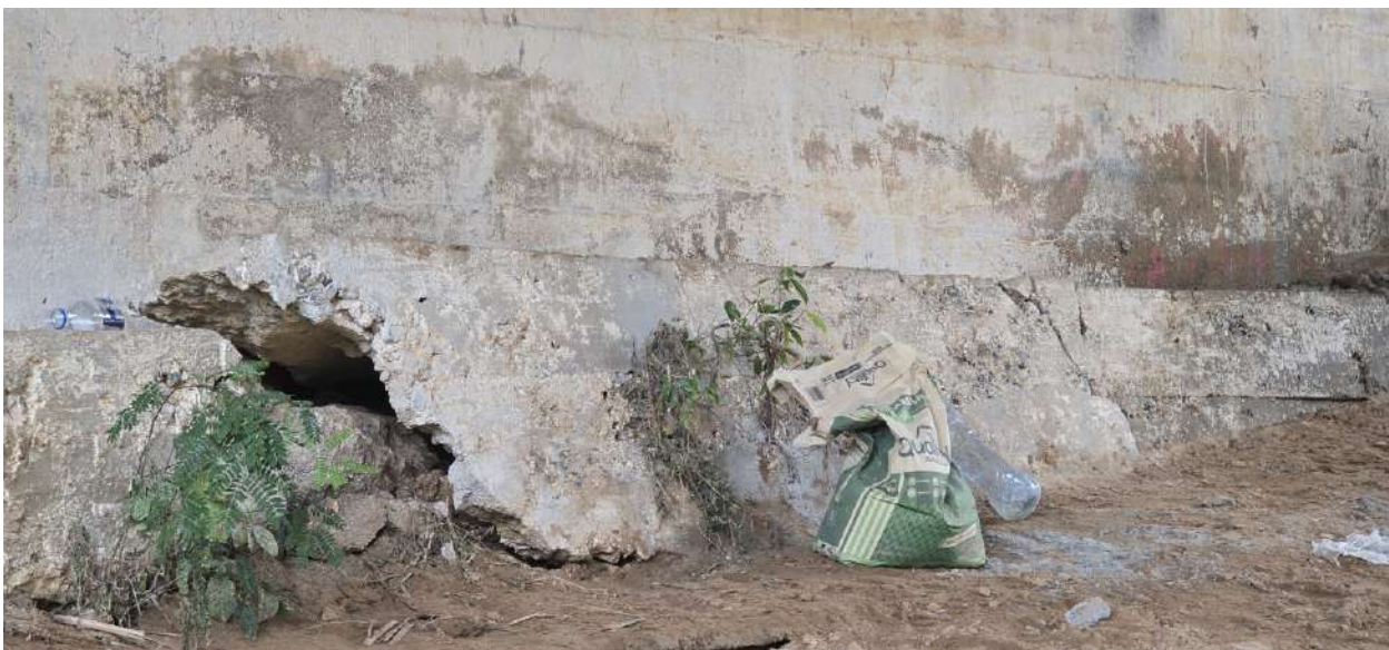
Imagem 72 Detalhe do pilar P1 face para o pilar P1. Bloco de coroamento de estacas com degradação severa no concreto, defeitos construtivos, deformações, concreto rompido, disgregação.
