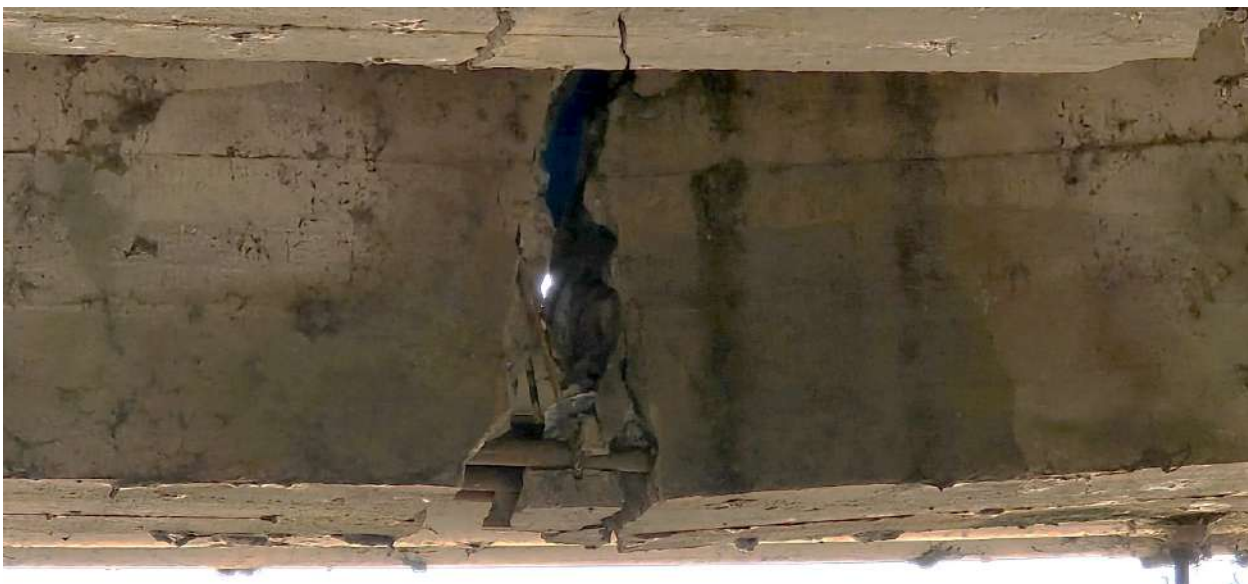
Imagem 49 Detalhe da viga longarina VL4 rompida em situação de colapso, próximo ao P2 vão entre P2 e encontro 2. Face montante.
